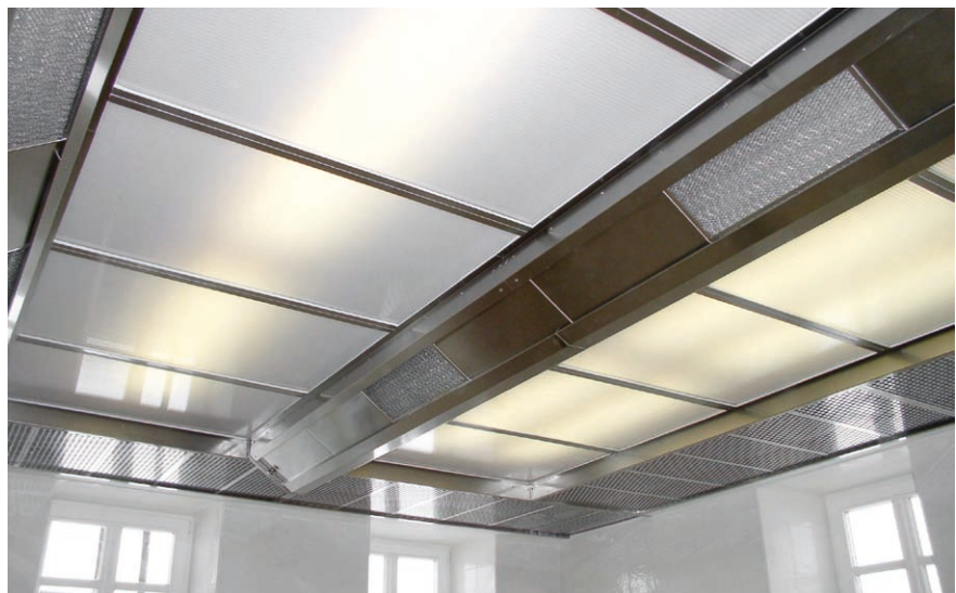
Obr. 1 – celoplošný větrací a osvětlovací strop TPV
