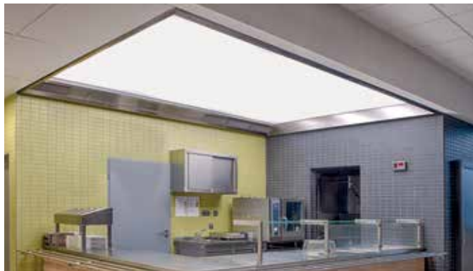
Obr. 10 – Otevřená kuchyně vybavená uzavřeným větracím stropem (integrované odsávací vzduchovody s tukovými filtry jsou umístěny po stranách větracího stropu)
